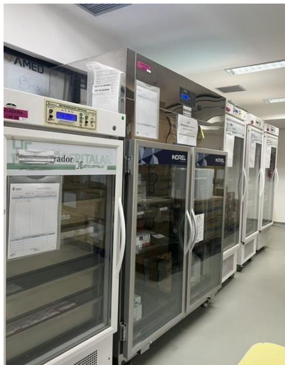
Refrigeradores com armazenamento dos medicamentos termolábeis
